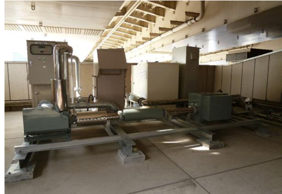
写真-1 送気システム本体
