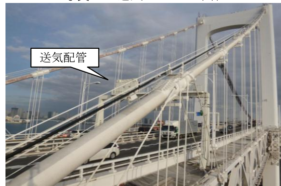
写真-2 送気配管
