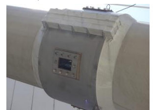
写真-4 モニタリングカバー
