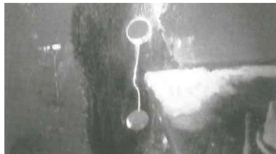
図-1 横構ガセット取付け部ウェブに生じたき裂の例 3)
