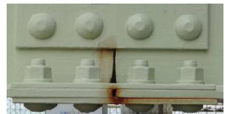
図2 さびの発生状況
