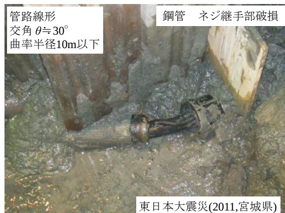
図-4 曲線区間の被災事例
