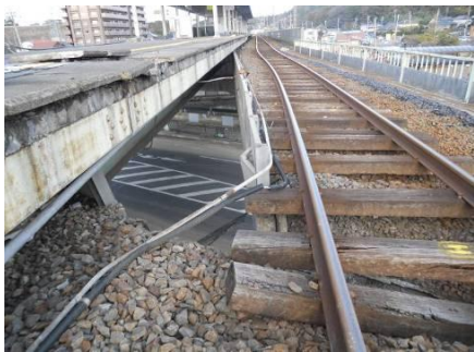
写真-1 斜角桁の被害状況
