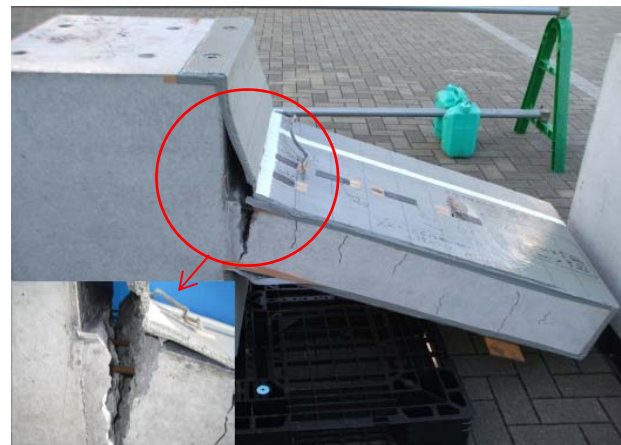
写真-3 RCT1 試験体の崩壊状況
