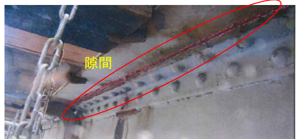
写真-1 隙間発生状況
