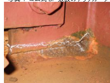
写真 2 端補剛材下端溶接部の全周き裂
