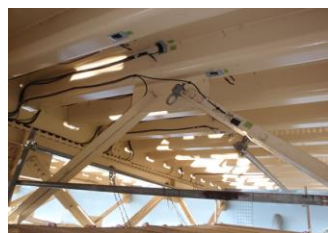
(d) 設置状況
