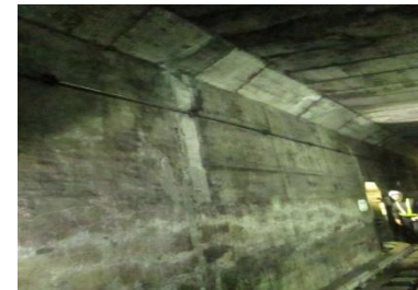
写真-3 断面の結合部のひび割れ
