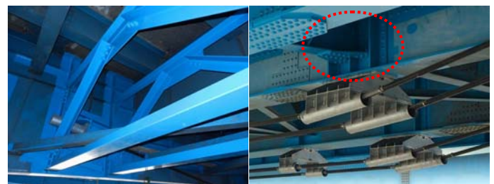
(a)定着部補強 (b)偏向具補強
