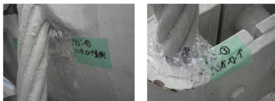
写真-3 改良工事後のケーブルバンド漏洩状況
