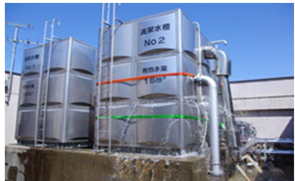
写真-1 貯水槽の被害
