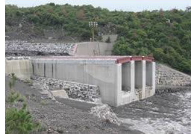
写真-1 底面水抜きスクリーン
