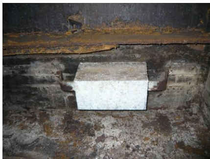
写真-2 亜鉛陽極残存状況
