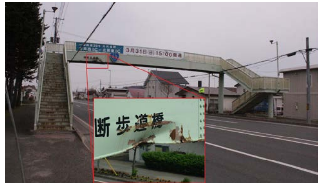
図 1 対象橋梁の全景と損傷部
