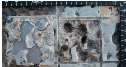
写真5 空洞への充填が不十分な状況
