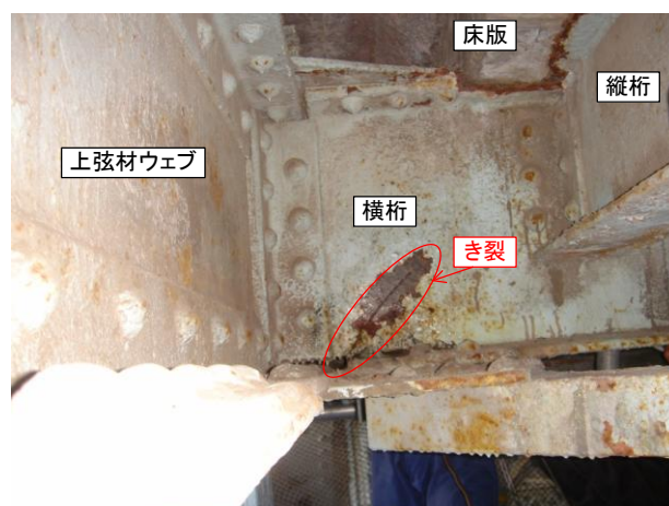
写真1. 実橋の損傷状況
