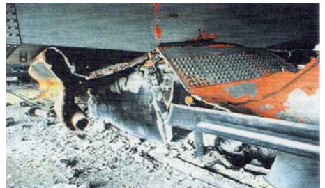
写真三 圧壊した鋼製橋脚
