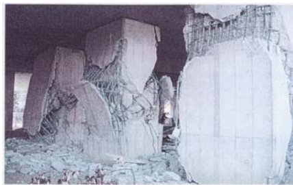
写真二 共役せん断破壊の橋脚
