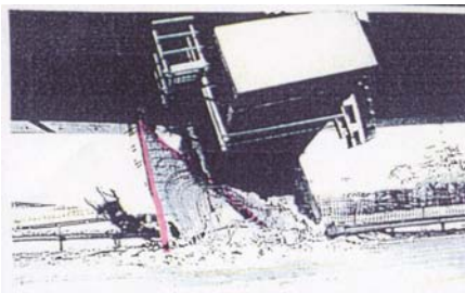
写真一 せん断破壊した橋脚
