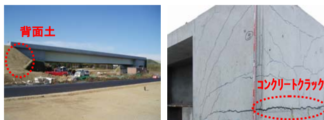
写真-1 橋台躯体のひび割れ位置
