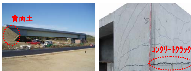
写真-1 橋台躯体のひび割れ位置
