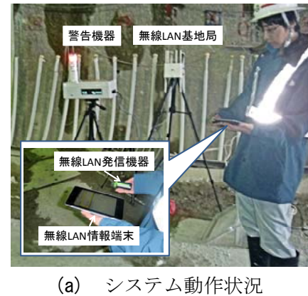
図-3 機器設置状況
