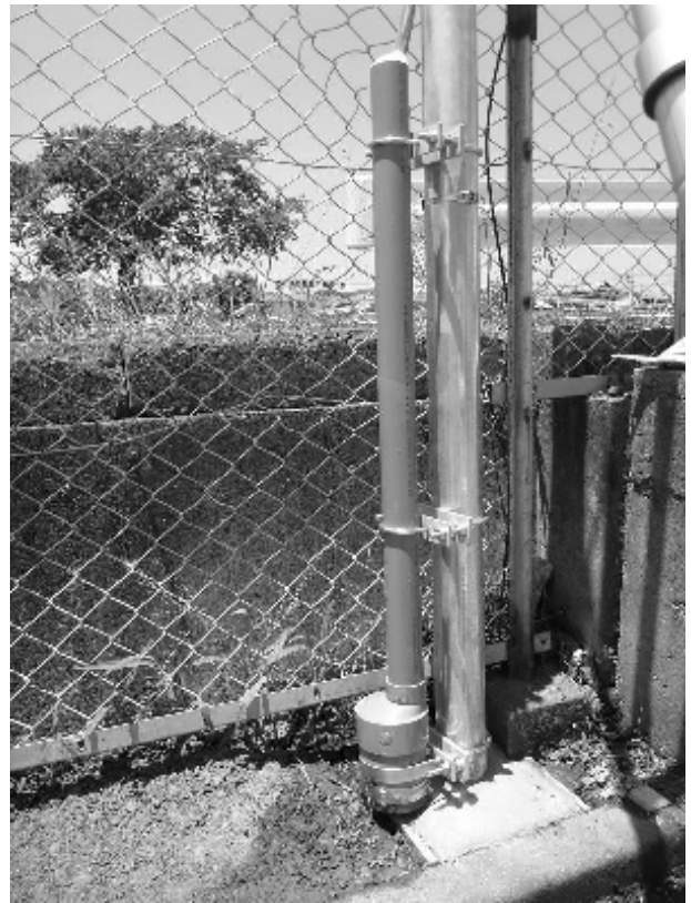
図-3 水位センサ IC タグ(現地設置状況)
