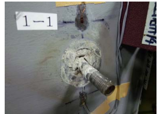
図6 PC 鋼棒接続部の状況
