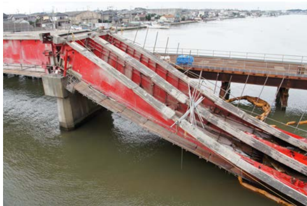
写真－1 横倒れ座屈を生じた主桁
