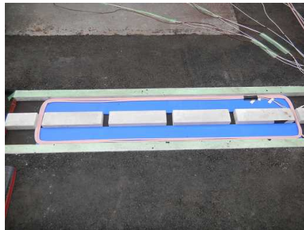
タイプ C コイル設置状況
