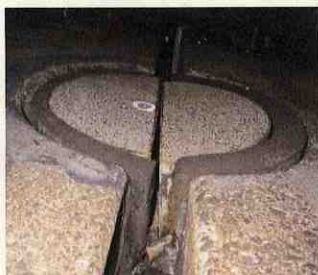
写真-1 突起の損傷例
