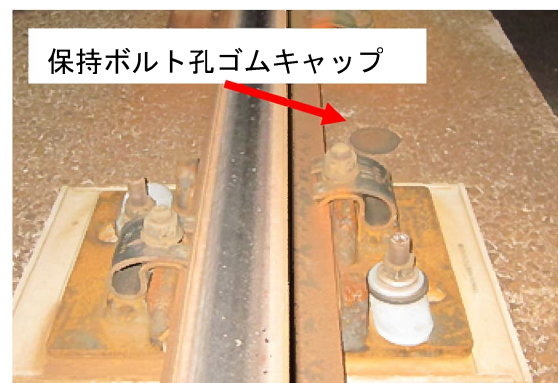
図 2 保持ボルト孔ゴムキャップ外観
