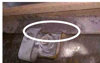
図 1-1 : レール底側部腐食例
