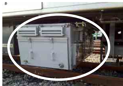
図 1-3 : 軌道材料モニタリング装置
