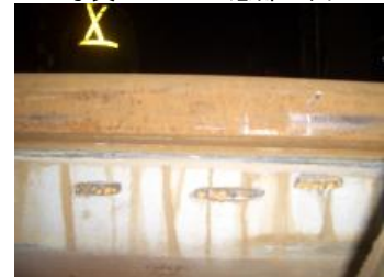
写真-5 レール腹部
