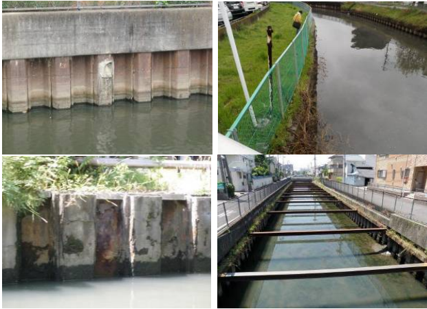
写真 1 伝右川に散見された鋼矢板護岸の問題点 (左上：破損、右上：傾き、左下：腐食、右下：切梁)
