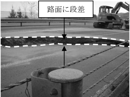
写真-1 補修に土工まで及ぶ箇所の例
