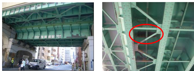
写真1 A 橋りょう(左：全景 右：漏水箇所)
