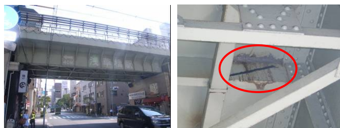
写真2 B 橋りょう(左：全景 右：漏水箇所)
