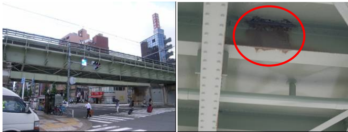
写真4 D橋りょう (左: 全景 右: 漏水箇所)
