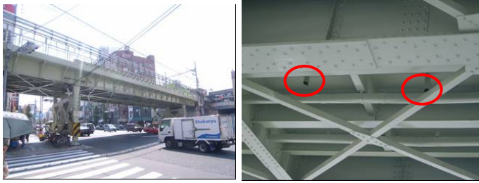
写真3 C橋りょう (左: 全景 右: 排水樋損傷)
