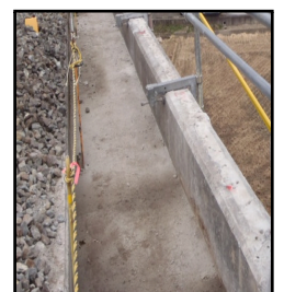
(写真-4)地覆凹凸状況
