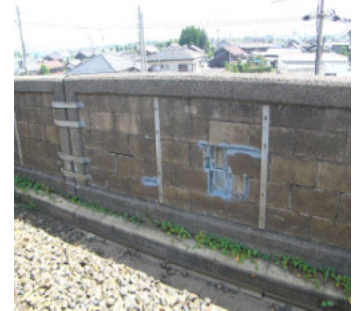
(写真-1)ブロック高欄変状事例
