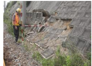
図-6 崩壊状況写真
