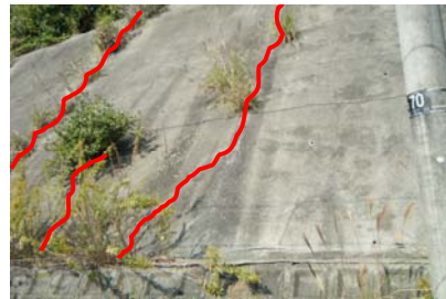
図-3 鉛直方向クラック
