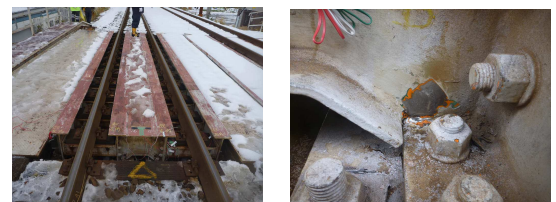
写真-1 槽状桁全景 写真-2 き裂概況
