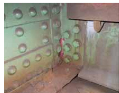
写真-2 連結山形鋼のき裂
