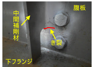
写真-2 補剛材下端変状
