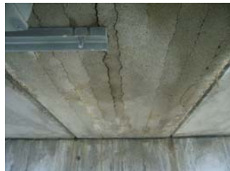
図-1 PC 中空板の劣化状況
