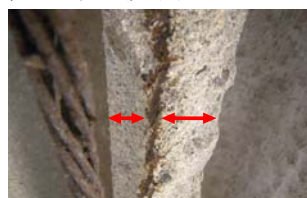
図-7 剥落箇所におけるPC鋼より線の配置誤差
