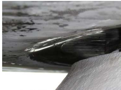
写真-2 ステンレス板変形状況
