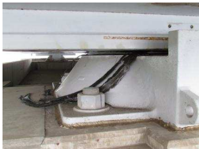
写真-1 せり出し状況
