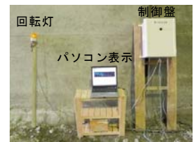
写真-1 制御システム
