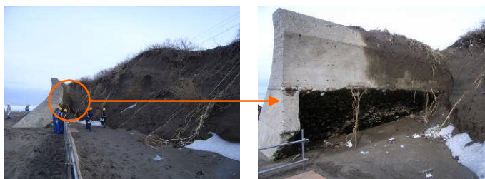
写真-1 海岸のり面侵食状況 (左) 全景写真、(右) 近景写真
