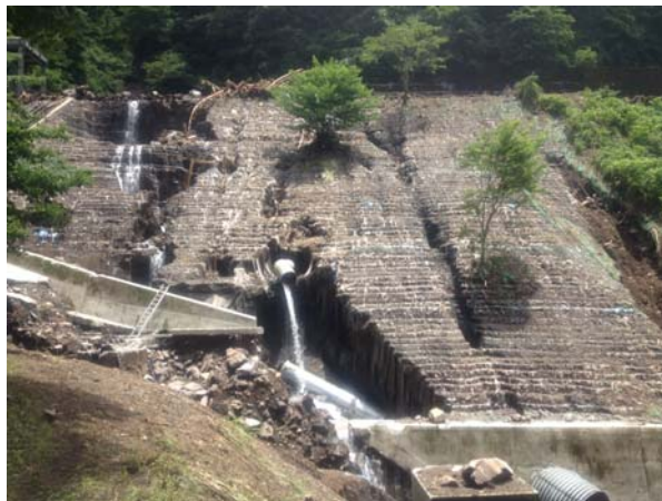
写真-1 災害状況
