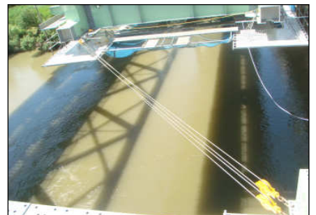
桁通り調整設備
