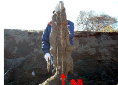
写真 5 連続した縦方向の亀裂
