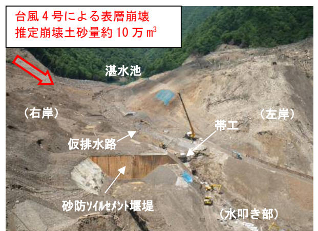
写真-5 平成 24 年台風 4 号後の仮排水路状況
