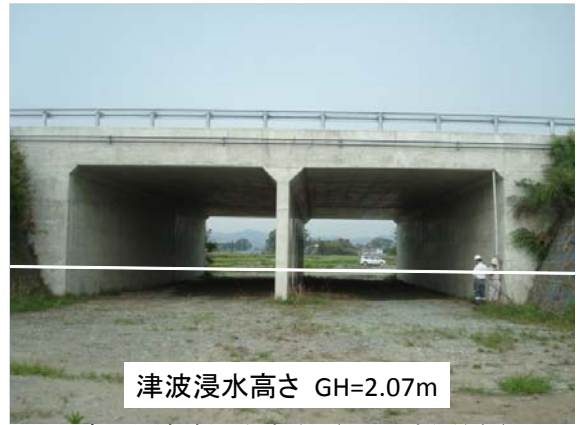
写真-3 津波浸水高さ (ランプ交差部)
