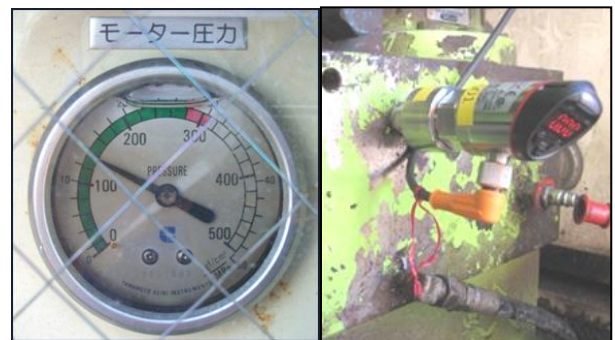
写真-2 既設圧力メータとデジタル圧力計
