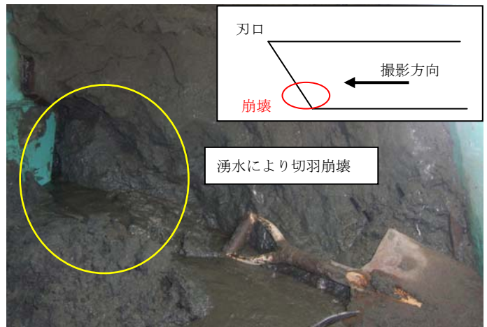
写真-2 湧水による切羽崩壊後の写真
