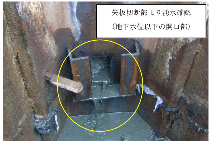
写真-1 鋼矢板切断部からの湧水状況（鏡切前）
