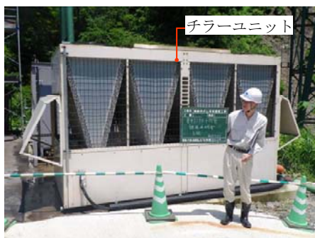
写真－1 チラーユニット
